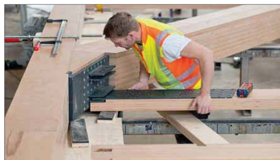
Montage eines exakt gefrästen Seitenholzes an den Stahlanschlussplatten des dreiteiligen Zugpfostens am Haupt-Fachwerkbinder Fotos: SWG Produktion
